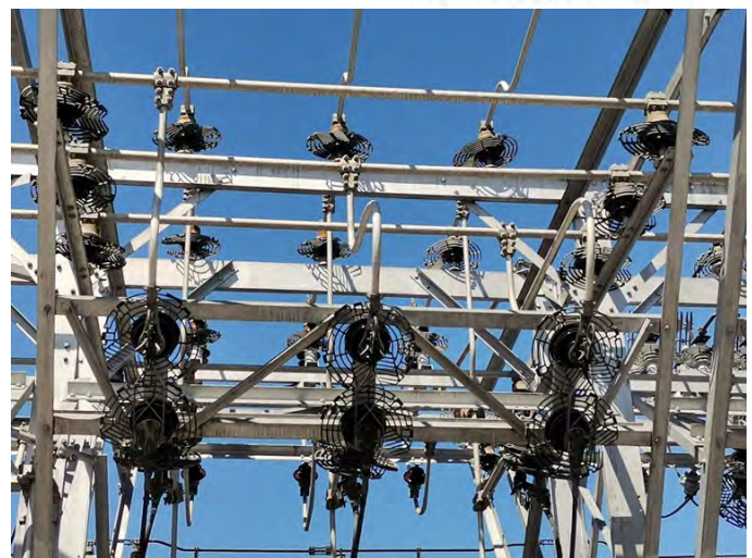
Figura 32. Imagen de arriba, dispositivo electrostático de polietileno, diseño y forma correcta de colocar. Imagen de abajo, dispositivos electrostáticos colocados sobre los aisladores de porcelana de los soportes de las cuchillas en una subestación, (imágenes fuente CNFL).
