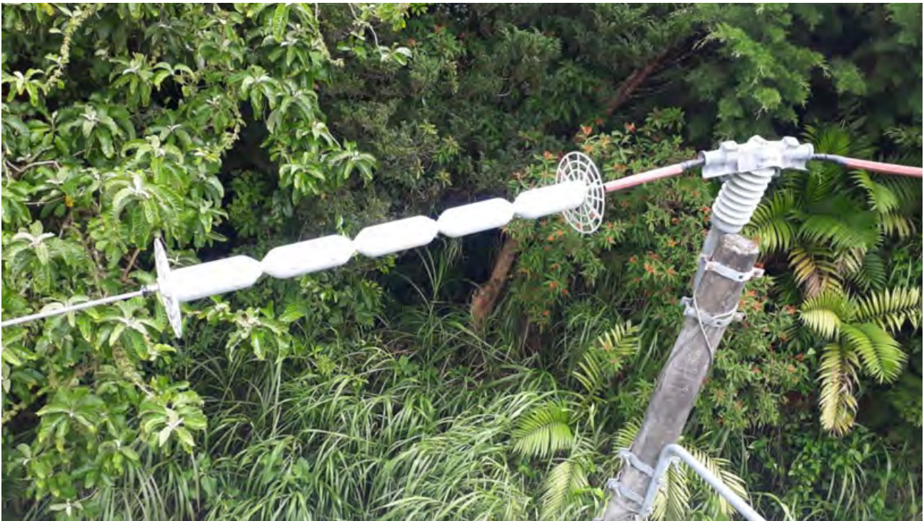
Figura 31. Dispositivo giratorio que evita ingreso de ardillas, primates, entre otros grupos de mayor movilidad a las redes eléctricas. (imágenes fuente ESPH).
