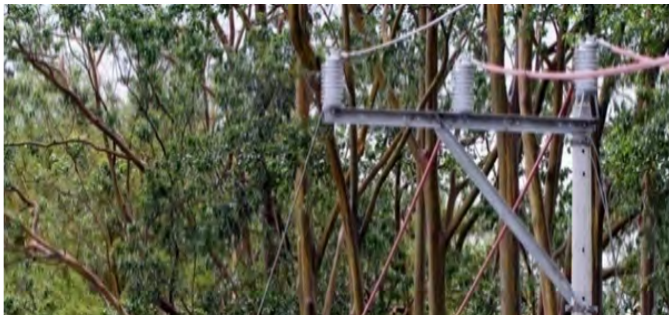
Figura 42. Líneas eléctricas convencionales protegidas con cobertor de polímero rígido y liviano (Fuente: ESPH).
